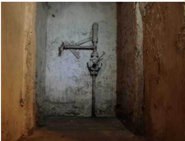
Fig. 14 - Sotterranei della chiesa denominata San Bernardino alle Ossa: pompa a mano per il sollevamento dell'acqua dal sottostante pozzo ordinario.
