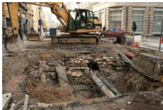
Anche a Gorizia, nel 2014, i lavori di manutenzione stradale hanno messo in luce antiche testimonianze del passato.
