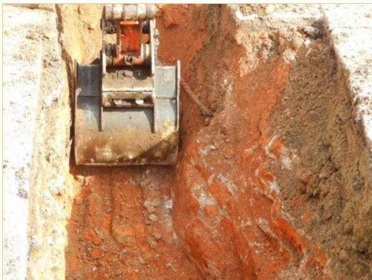
Fig. 51b - 16 ottobre 2016: sempre con grande spensieratezza si demolisce il rinascimentale Baluardo Albuquerque, situato in Piazza Castello, facente parte della Fortezza Reale. Seppure l'area sia tutelata si rovina e non si studiano le opere architettoniche del passato.
