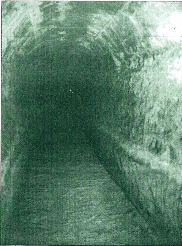
Figura n° 17. L'interno del cunicolo a monte dell'acquedotto di Mompiano, a sud di piazzetta S. Giorgio (foto D. Gallina).
