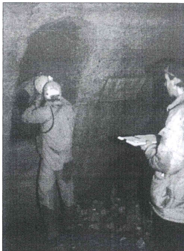
Figura n° 15. Il ramo a monte dell'acquedotto di Mompiano, tagliato dalla galleria di via Pulusella realizzata nel corso della II guerra mondiale (foto D. Gallina).
